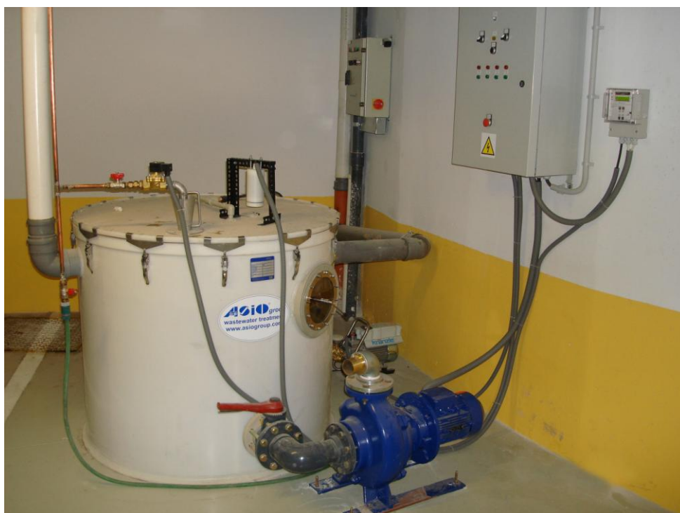
Εικόνα 1. Άποψη αυτόματου λιποσυλλέκτη
